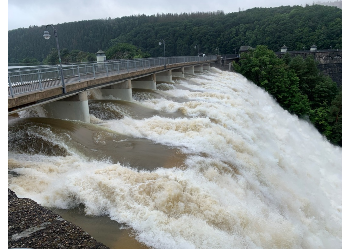
Überlauf der Urfttalsperre am 15.07.21
